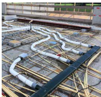
Hoofdkanaal met ventilatieslang
